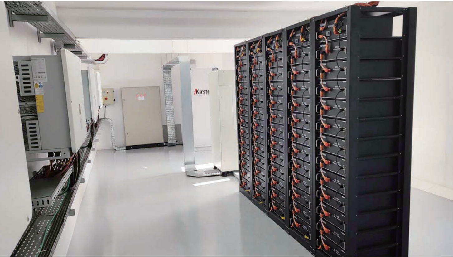
• 巴西 PowerRack HV4 100kW/307kWh 动态扩容+光伏消纳
