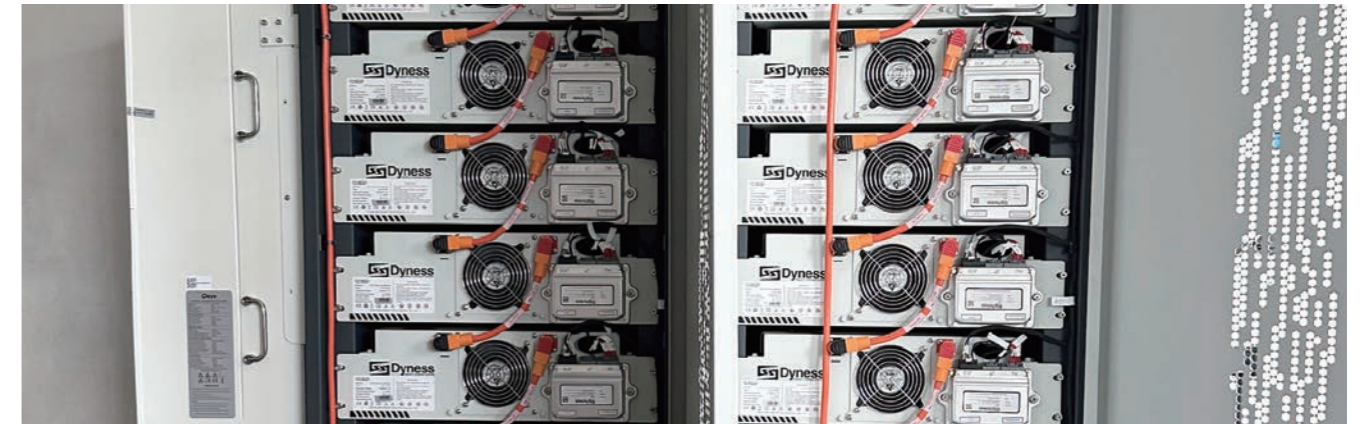
• 保加利亚 PowerRack HV4F 112.64 kWh 峰谷套利+自发自用
