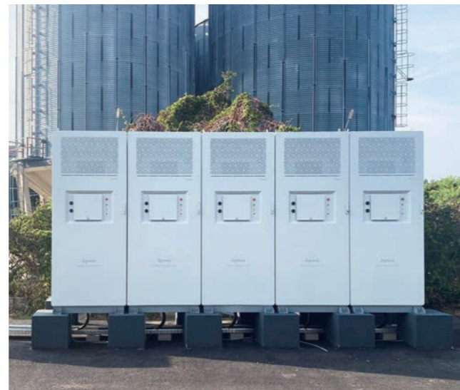
• 匈牙利 DH200Y 500kW/1160kWh 自发自用+光伏消纳
